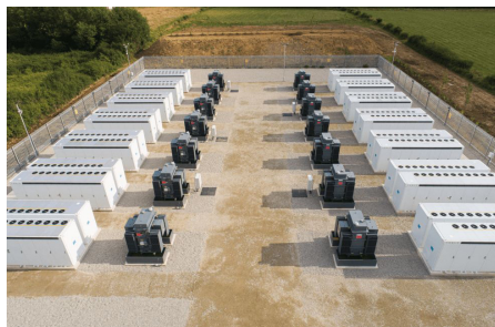
電池電力貯蔵システム (Battery Energy Storage System)
