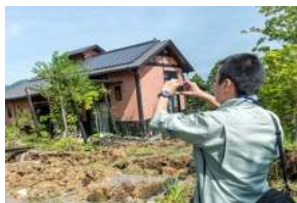
現場での損害確認
