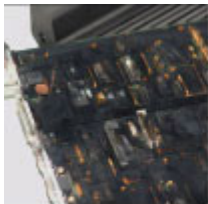
汚染された設備
