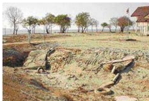
マングローブのなかったタイ・ラノーン近郊タレノーク。被害が生まれました。
